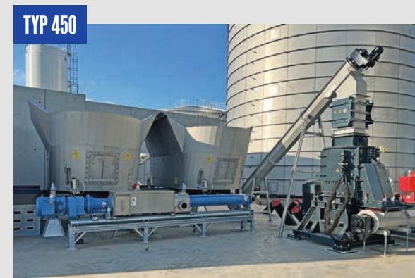
Zwei eigenständige Zuführsysteme beschicken zwei Flüssigeintragsysteme. Einer von ihnen fördert über ein zweiteiliges Förderschneckensystem TYP 450 mit Magnetabscheider in einen Vertikalzerkleinerer. Mit einer Flex-Übergabe TYP 450 wird es dann in ein ex-ternes Flüssigeintragsystem transportiert. Der andere ist mit einer Unterbauschnecke mit flexiblem Übergang TYP 450 ausgestattet, die in ein externes Flüssigein-tragsystem fördert.
