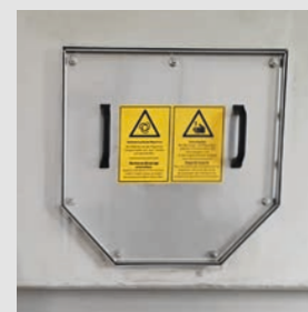
Apertura per la manutenzione
